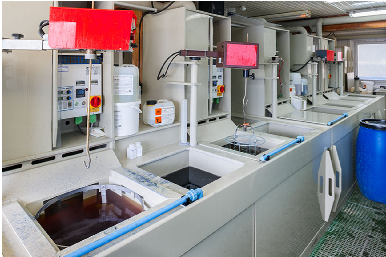
Usine : atelier de galvanoplastie (installations de l'îlot central depuis l'angle est).
