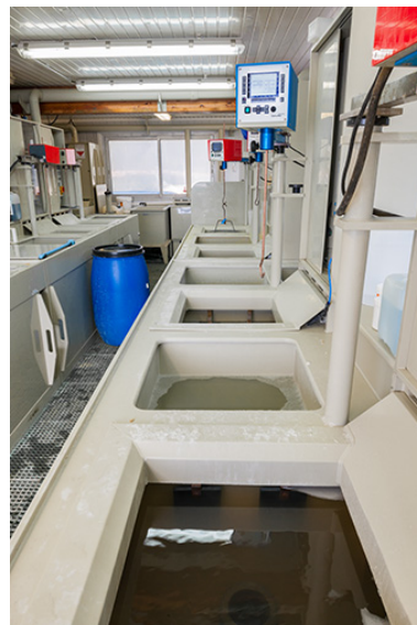
Usine : atelier de galvanoplastie (installations à l'arrière de la façade latérale gauche). Phot. Jérôme Mongreville IVR43_20142500301NUC4A
