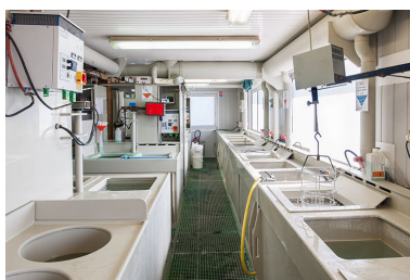
Usine : atelier de galvanoplastie (installations à l'arrière de la façade postérieure). Phot. Jérôme Mongreville IVR43_20142500297NUC4A
