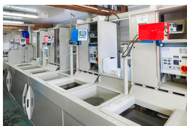
Usine : atelier de galvanoplastie (installations à l'arrière de la façade latérale gauche). Phot. Jérôme Mongreville IVR43_20142500303NUC4A
