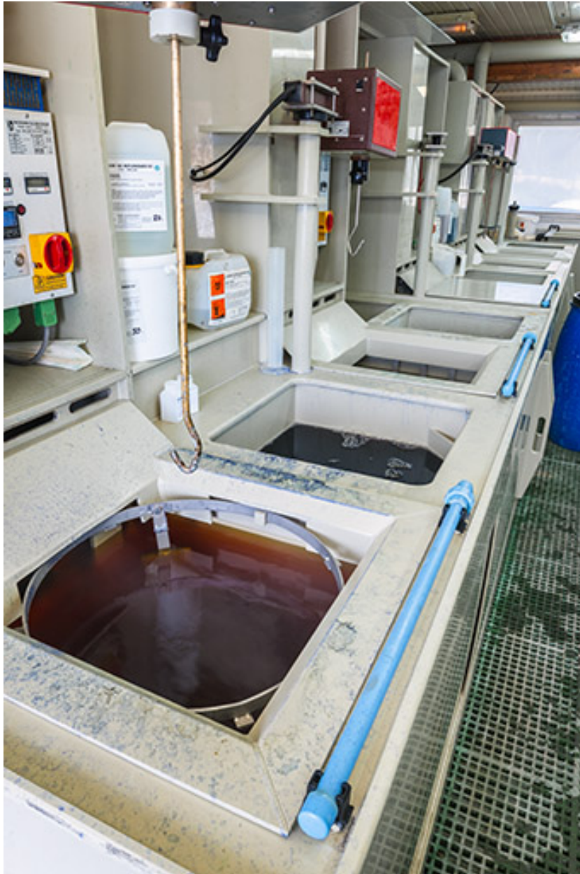
Usine : atelier de galvanoplastie (installations de l'îlot central depuis l'angle est).
