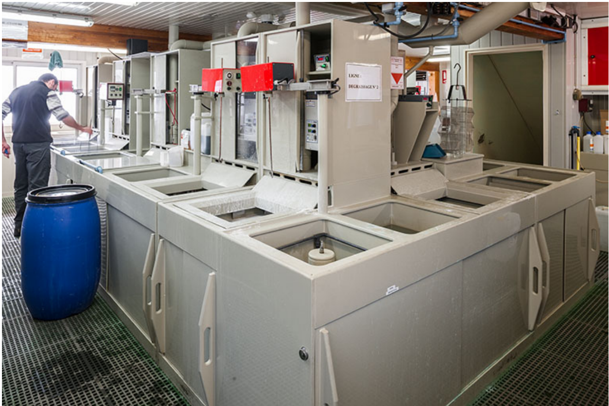
Usine : atelier de galvanoplastie (installations de l'îlot central depuis l'angle nord).
