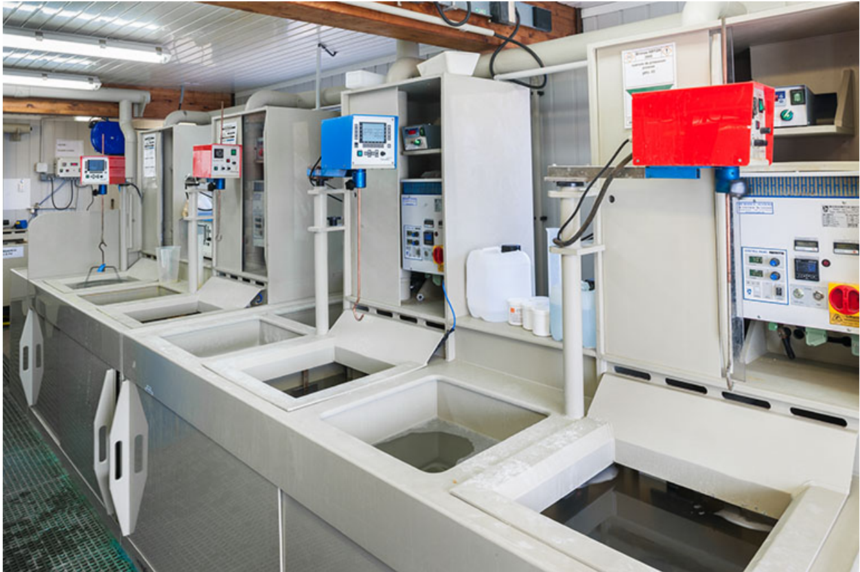
Usine : atelier de galvanoplastie (installations à l'arrière de la façade latérale gauche).
