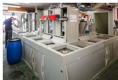
Usine : atelier de galvanoplastie (installations de l'îlot central depuis l'angle nord). Phot. Jérôme Mongreville IVR43_20142500299NUC4A
