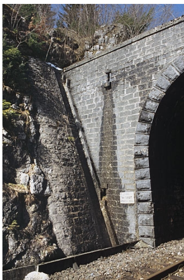
Tête côté La Cluse : descente d'eau, chantepleurs et caniveau. Phot. Yves Sancey IVR43_20053900239ZA
