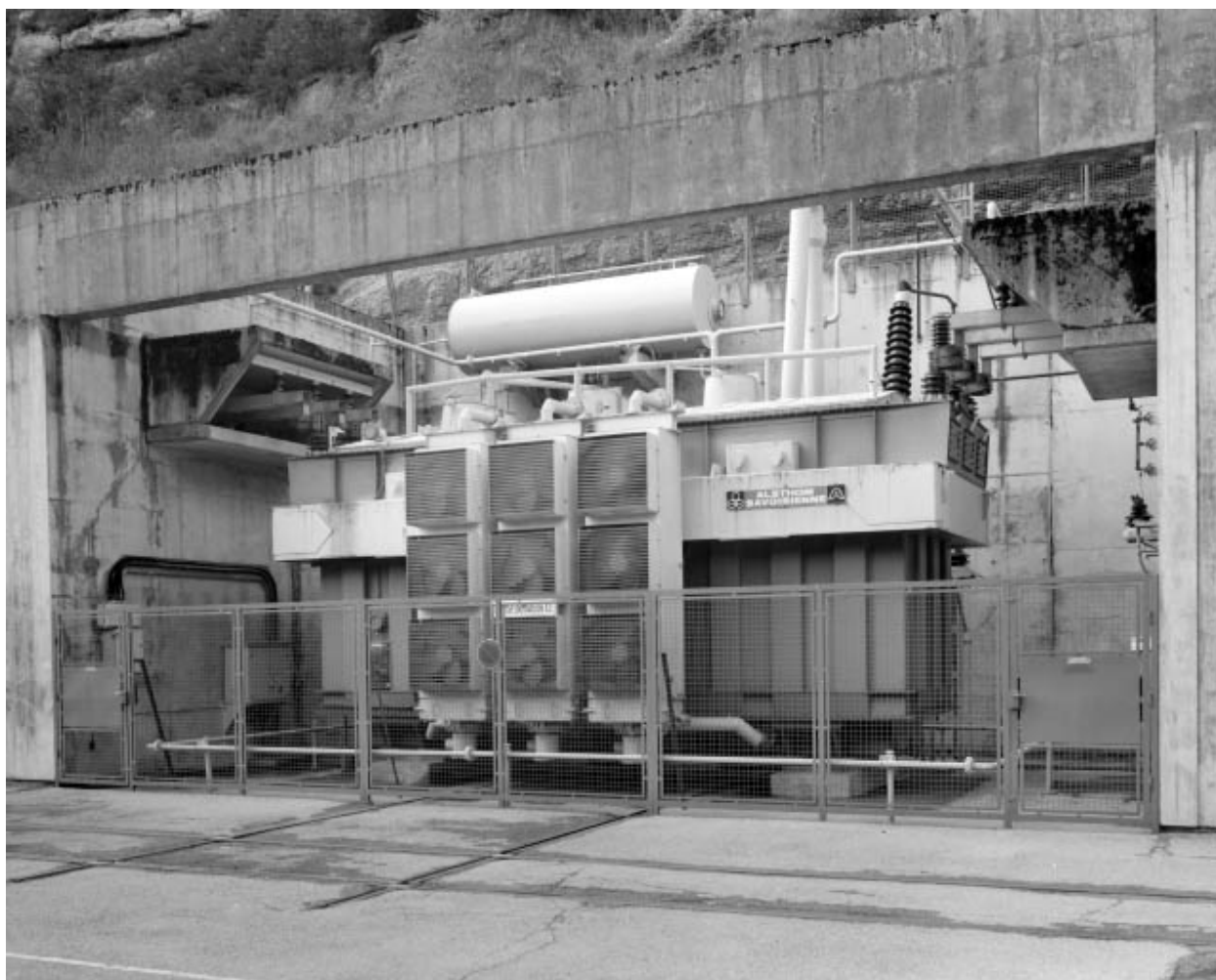
Transformateur Alsthom de 160 MVA.
