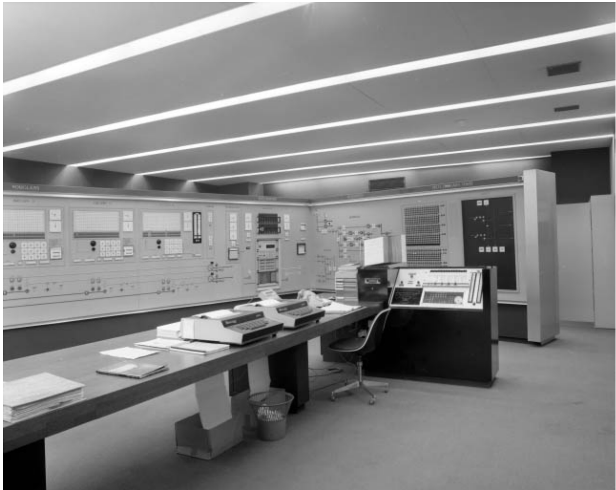
Vue d'ensemble de la salle de commande.
