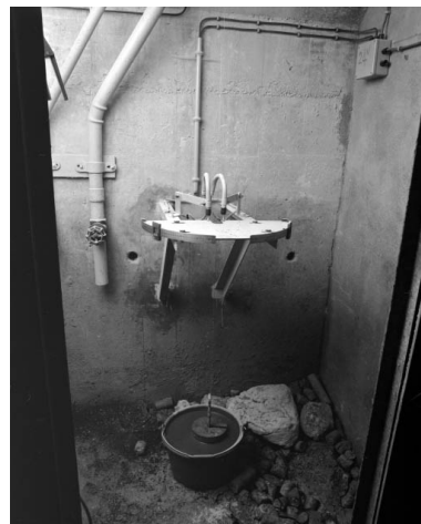
Système d'auscultation du barrage : pendule. Phot. Jérôme Mongreville IVR43_19913900681X
