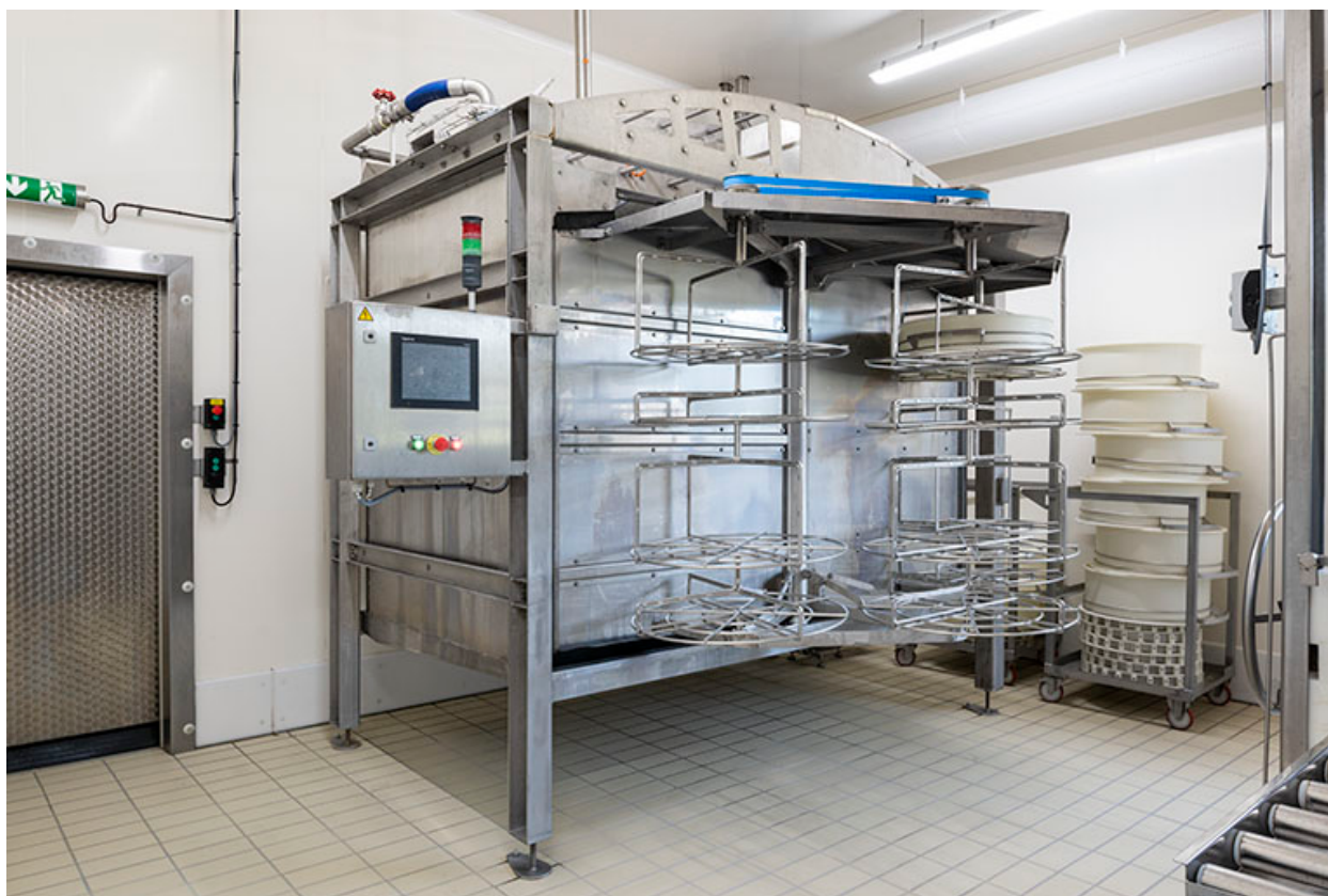
Installation de lavage.
