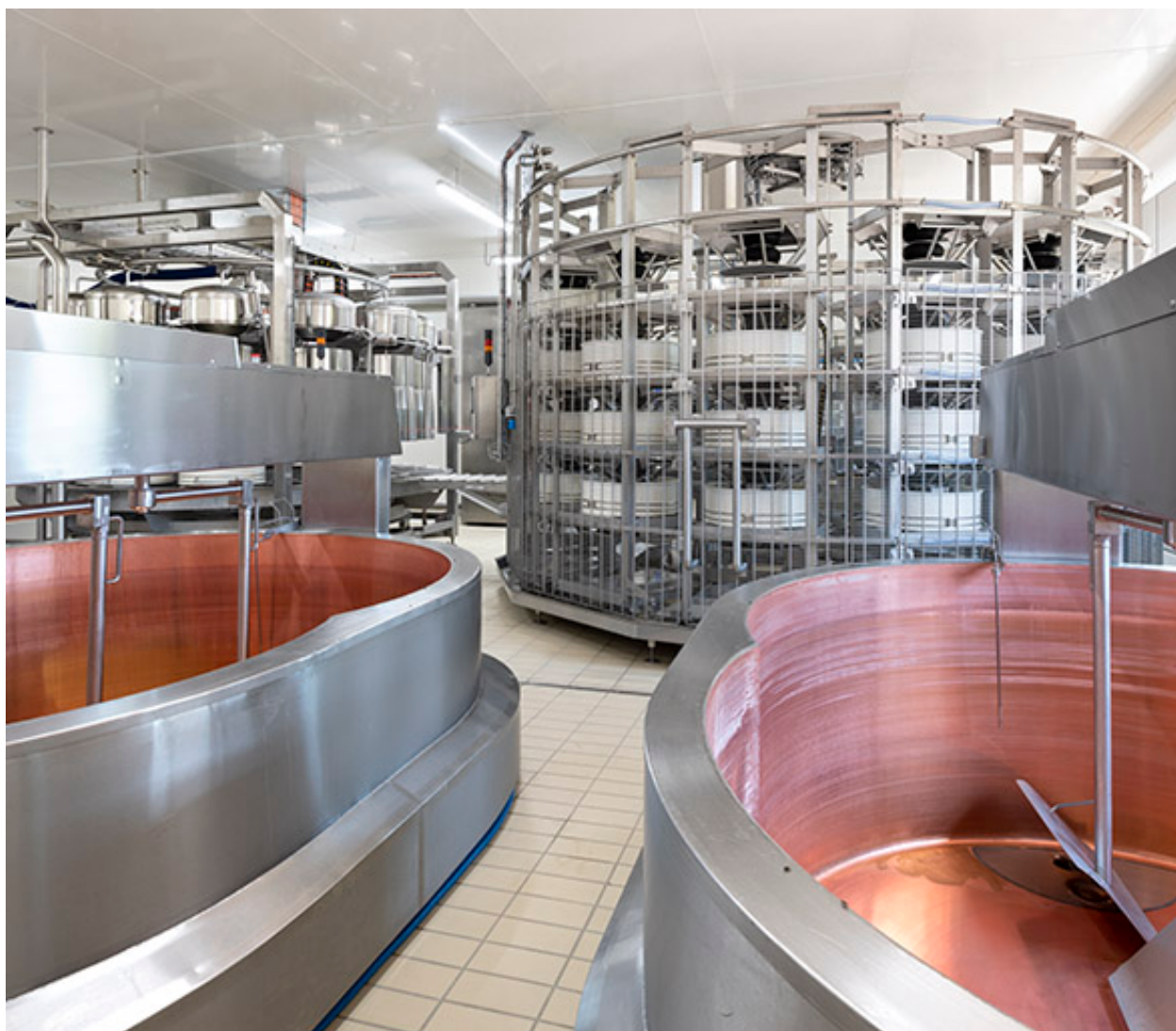
Installation de pressage, vue depuis les cuves.
