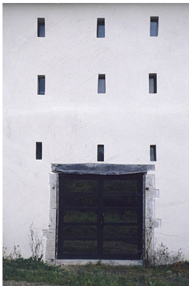
Détail de la façade nord de l'ancienne halle à charbon. Phot. Yves Sancey IVR43_20009000760ZA
