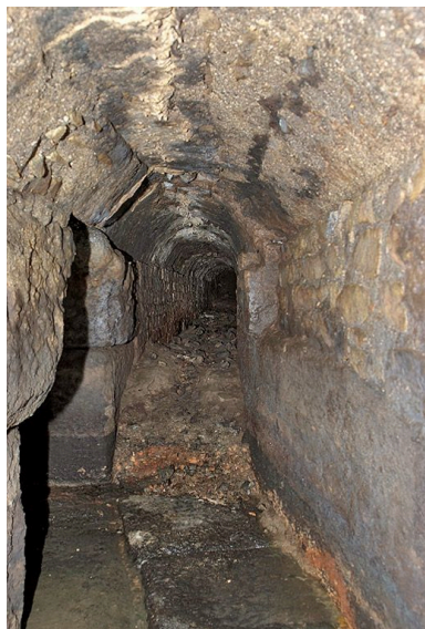
Première galerie : partie ouest partiellement obstruée par des gravats. Phot. Pierre-Marie Barbe-Richaud IVR26_20107101041NUC2A
