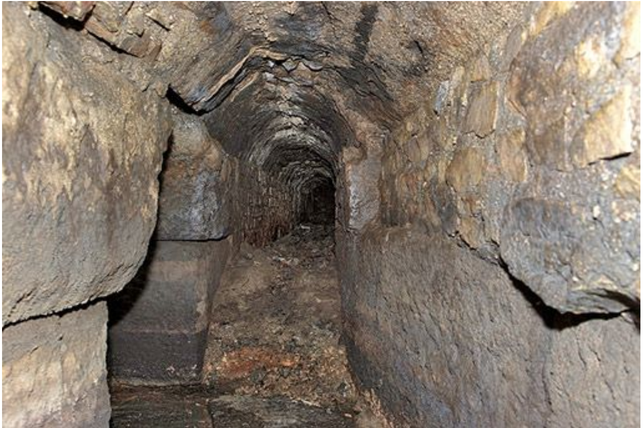
Première galerie : partie ouest partiellement obstruée par des gravats.
