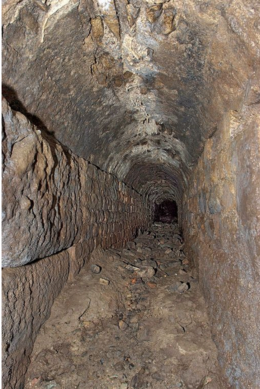
Première galerie : partie ouest partiellement obstruée par des gravats.
