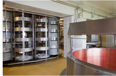
Groupe de pressage. Phot. Yves Sancey IVR43_20132501220NUC2A
