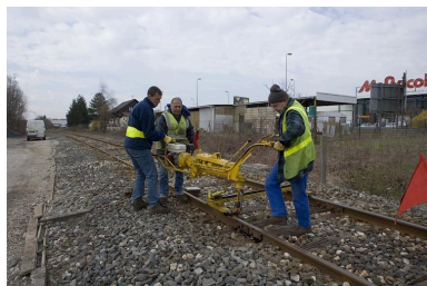
Mise en place par les agents de l'Équipement. Phot. Yves Sancey IVR43_20070100016NUCA
