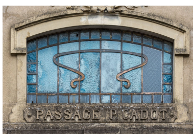
Façade antérieure : inscription et ferronnerie de la fenêtre centrale. Phot. Pierre-Marie Barbe-Richaud IVR26_20257100381NUC4A
