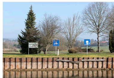
Détail des palplanches le long de la berge. Phot. Sonia Dourlot IVR43_20167000198NUC4A
