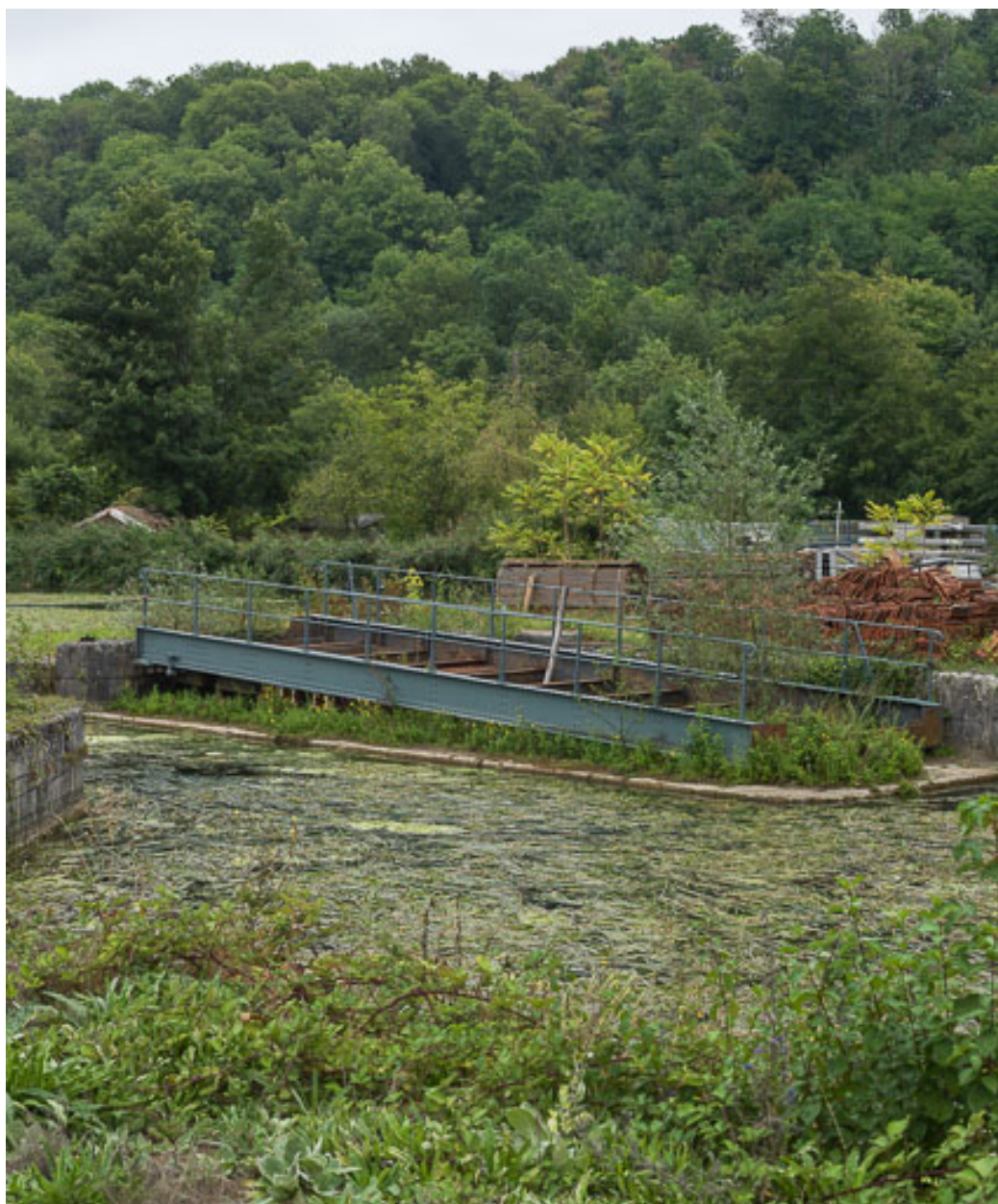
Vue du pont, à l'abandon.
