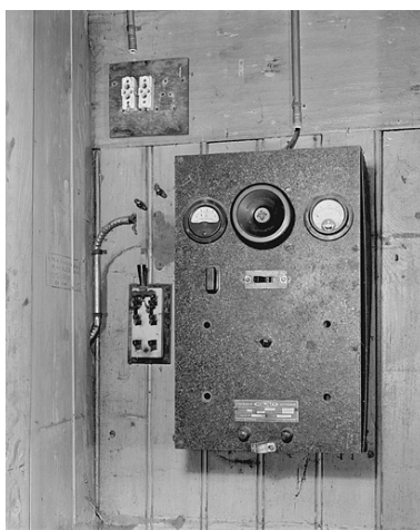
Chargeur de batterie Oxymétal Westinghouse : vue d'ensemble. Phot. Jérôme Mongreville IVR43_20022501221V
