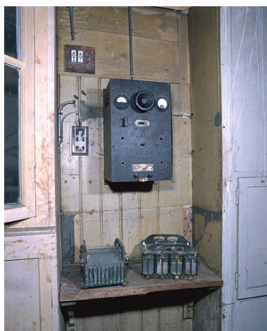
Chargeur de batterie Oxymétal Westinghouse : vue d'ensemble du chargeur et des batteries. Phot. Jérôme Mongreville IVR43_20032501043XA
