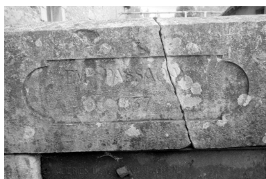
Inscription sur le garde-corps de la passerelle. Phot. Laurent Poupard IVR43_19933900450Z
