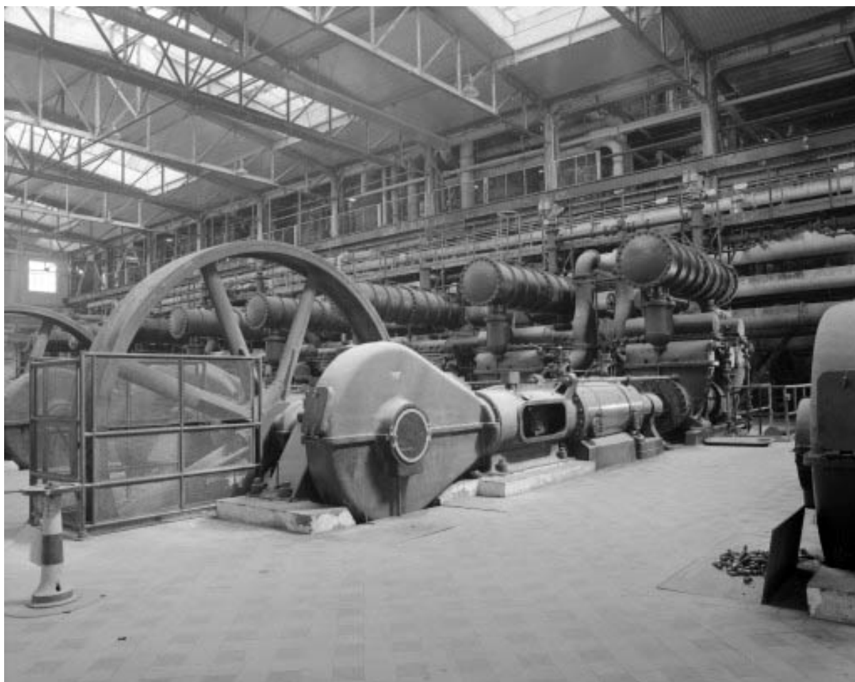
Soudière, salle des machines : pompe n° 4 vue de trois quarts. De gauche à droite : volant d'inertie, bielle (couvercle de protection enlevé), cylindre à vapeur, compresseurs.
