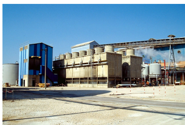
Tours de réfrigération (38) de l'usine d'électrolyse. Phot. Yves Sancey IVR43_19893900388ZA
