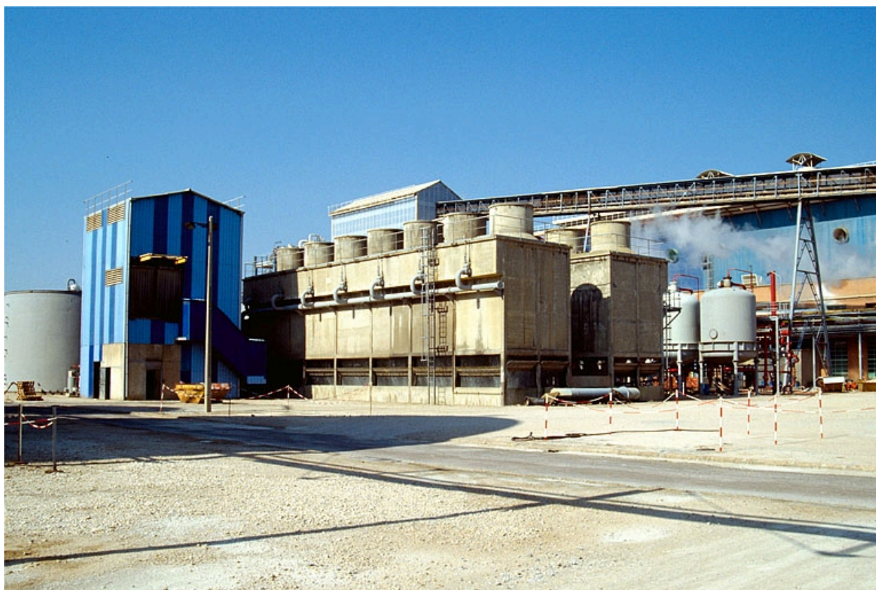
Tours de réfrigération (38) de l'usine d'électrolyse.
