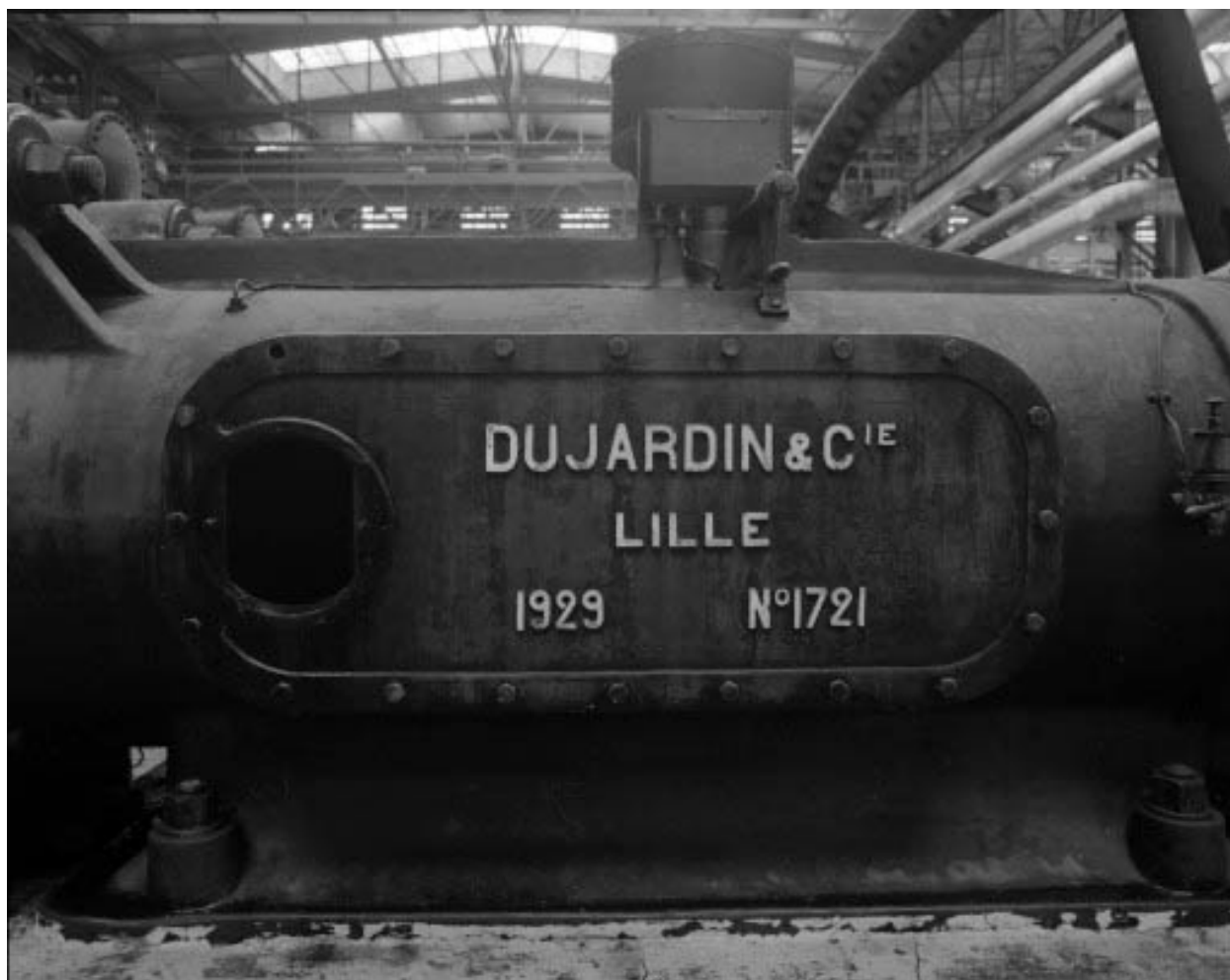
Soudière, salle des machines : plaque de constructeur de la pompe n° 2.
