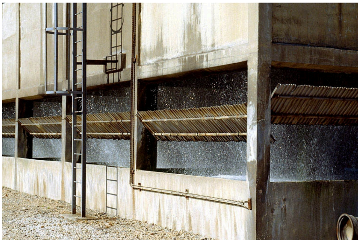
Détail de l'une des tours de réfrigération.
