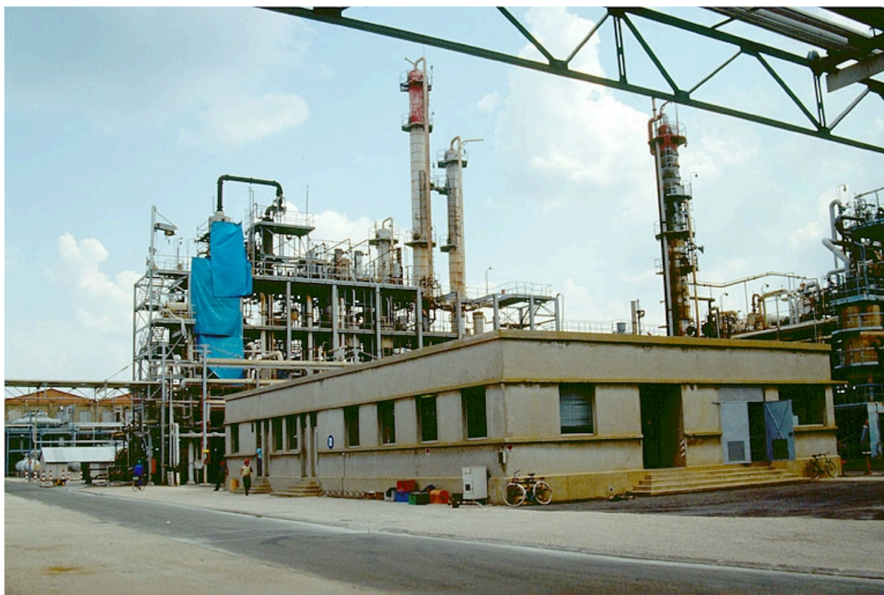
Salle de contrôle (34) du TRI71.
