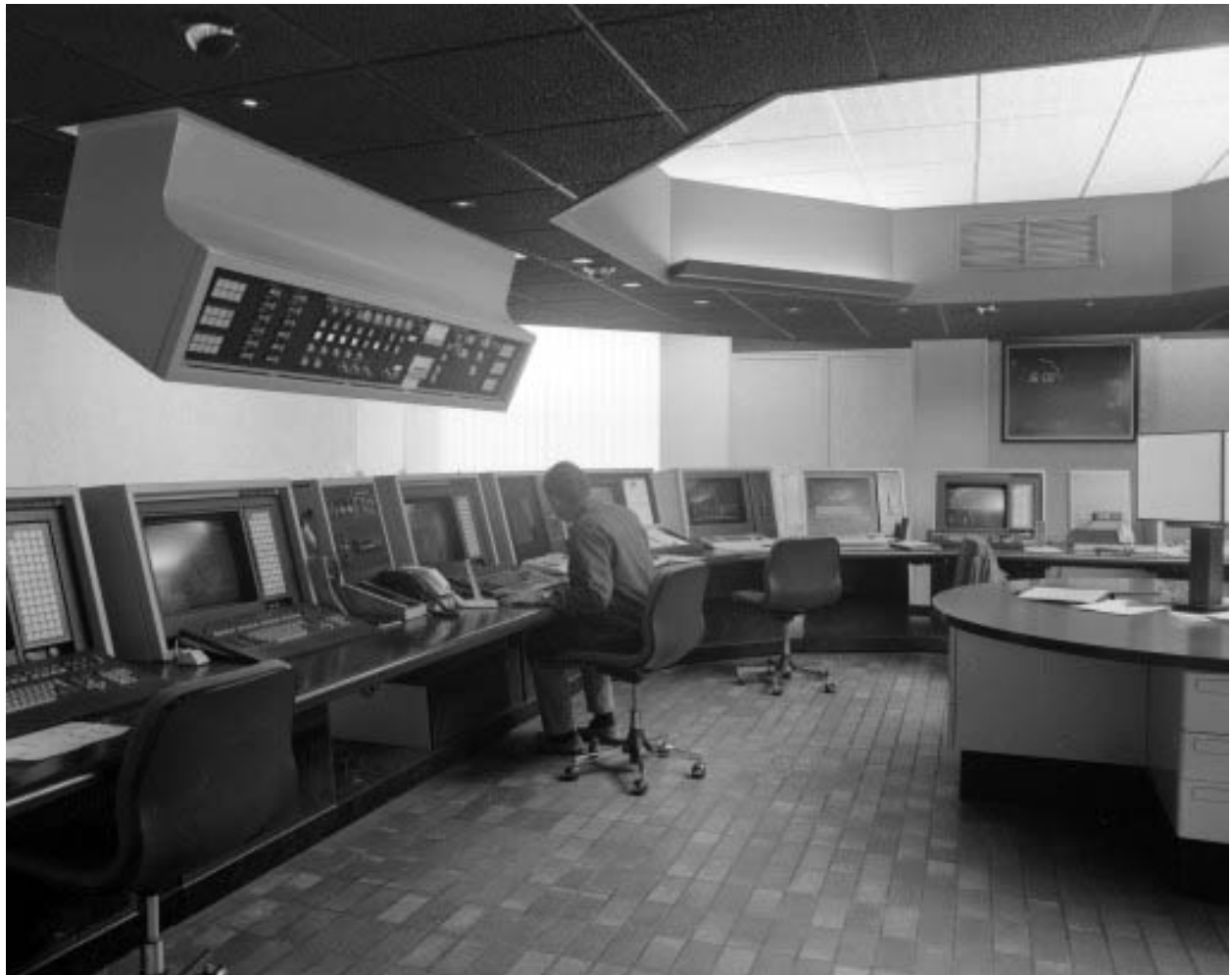
Intérieur de la salle de contrôle de la Salle 5 : écrans de contrôle.
