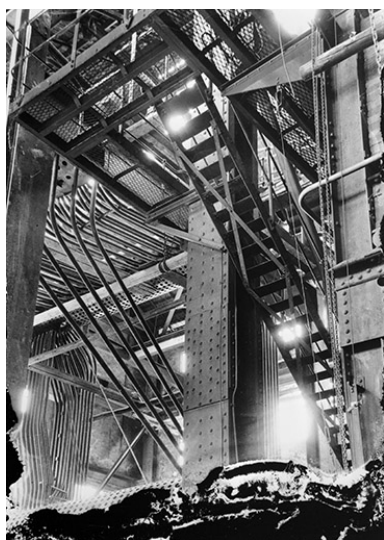
Tuyauterie des générateurs de vapeur au charbon. Phot. Jérôme Mongreville, Phot. Charnotet IVR43_19903900040X
