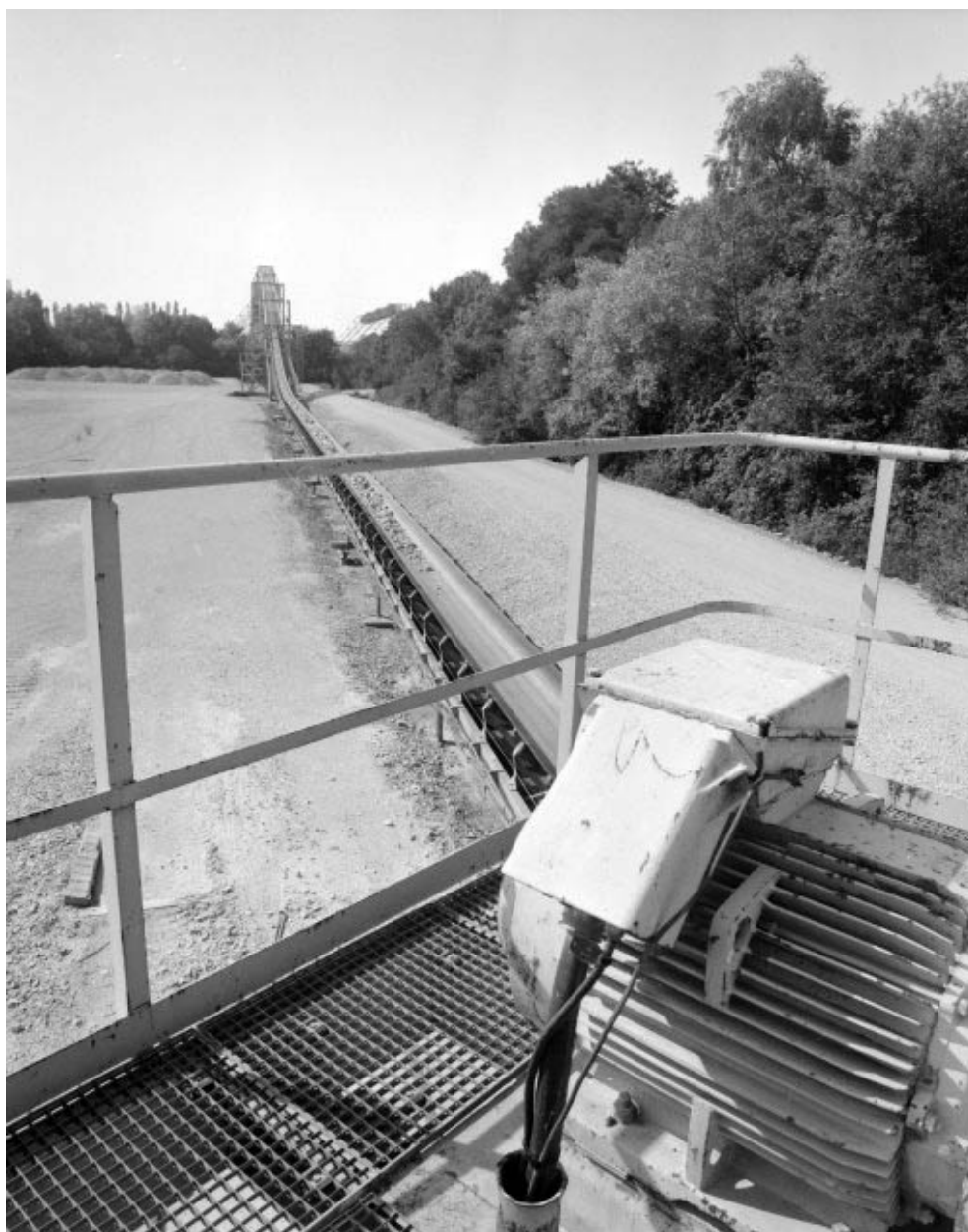
Transporteur automatique à bande et portique sur le canal, vus depuis l'installation de renvoi (3).
