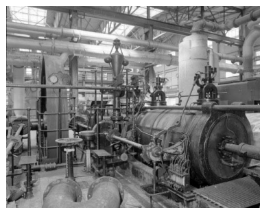
Soudière, salle des machines : volant d'inertie, régulateur à boules et cylindre à vapeur de la pompe n° 1. Phot. Yves Sancey IVR43_19893900420X
