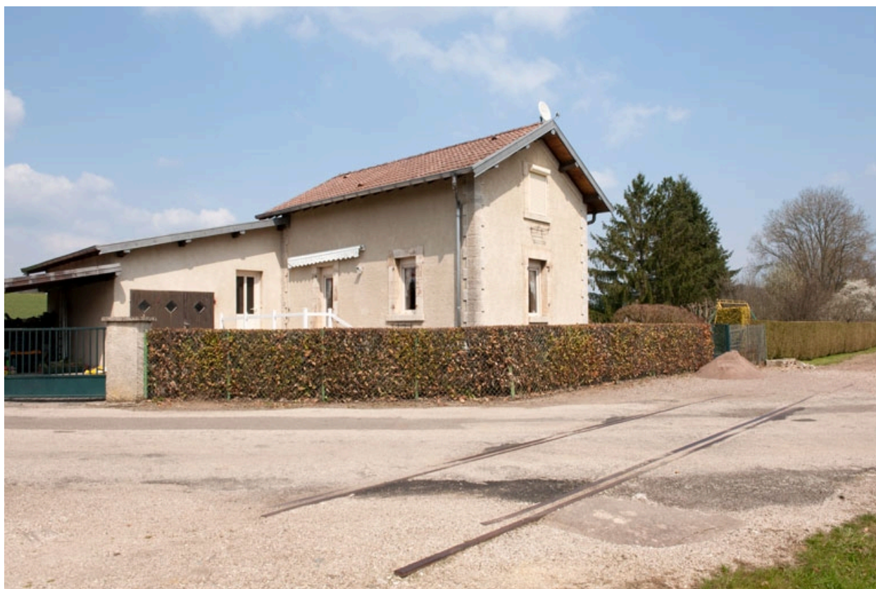
Maison de garde-barrière, chemin du Souvenir français : vue rapprochée. Noter les rails encore en place.
