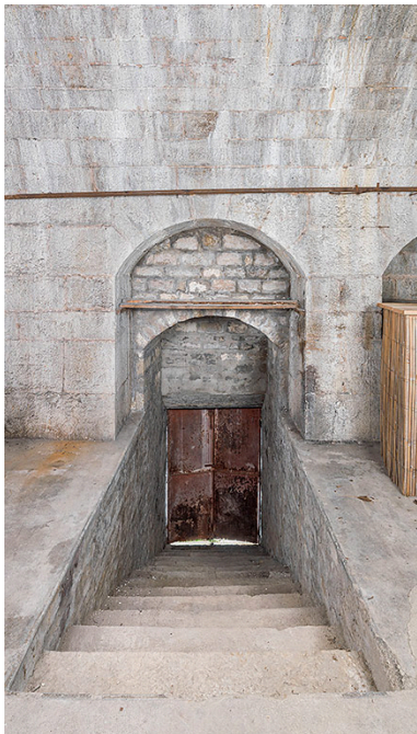
Escalier intérieur vers la poterne dans la casemate. Phot. Thierry Kuntz IVR43_20252500057NUC4A
