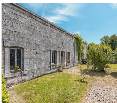
Les casemates conservées et transformées en locaux techniques. Phot. Thierry Kuntz IVR43_20252500465NUC4A
