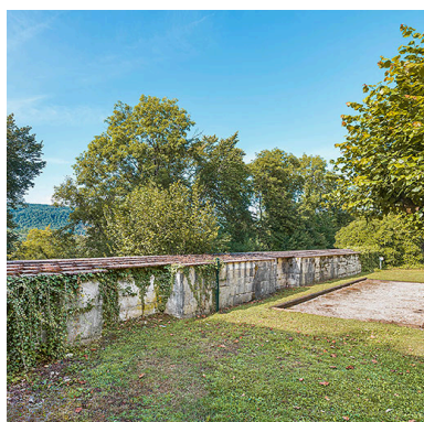
La courtine sud, vue (rapprochée) depuis la cour intérieure. Phot. Thierry Kuntz IVR43_20252500471NUC4A
