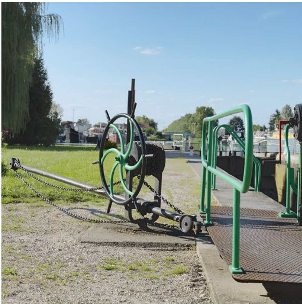
Détail du mécanisme des portes du sas.
