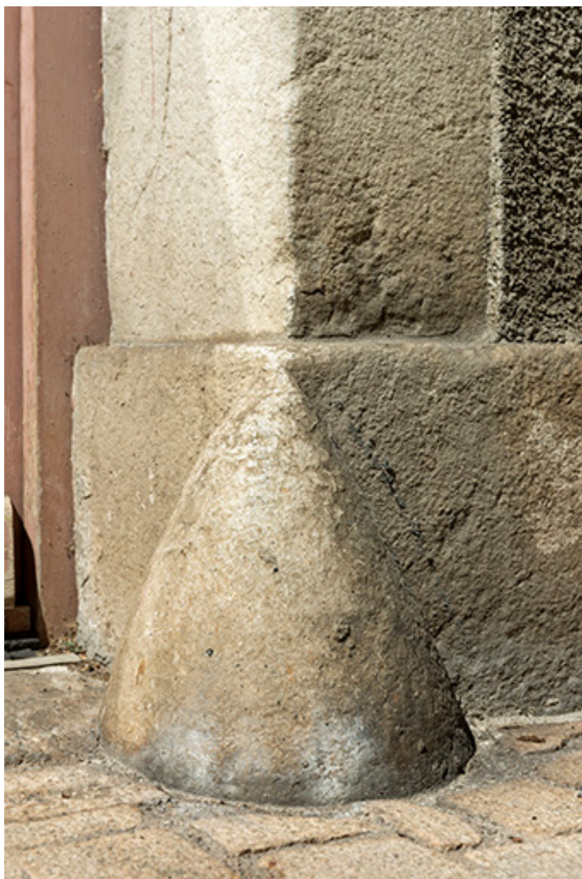
Immeuble 2 rue Jacques Courtois : chasse-roue.
