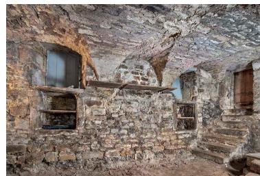
Mur ouest (sur la rue du Chambenoiz) de la cave. Phot. Jérôme Mongreville IVR43_20223901053NUC4A
