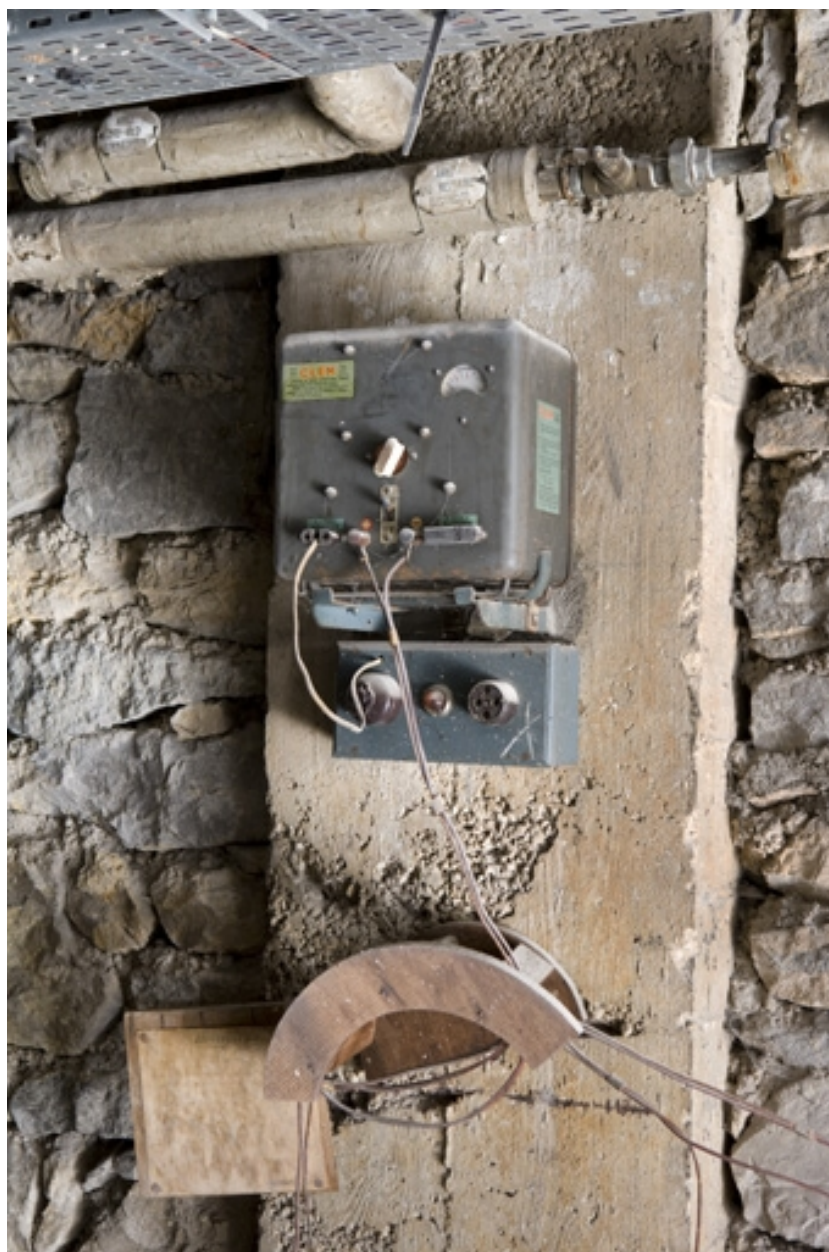
Aile sud, garage du directeur : ancien chargeur de batterie.
