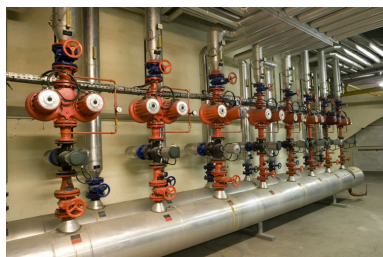
Corps d'entrée, chaufferie : détail des pompes. Phot. Yves Sancey IVR43_20092501520NUC2A
