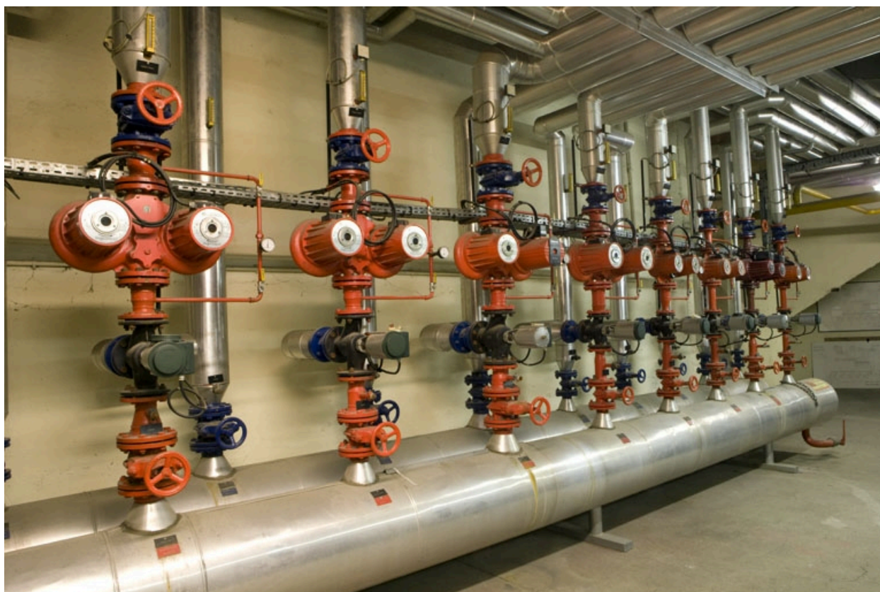
Corps d'entrée, chaufferie : détail des pompes.
