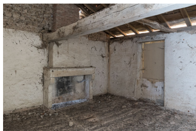
Chambre à l'étage, dans l'ancienne maison. Un plancher sépare la pièce des combles, au niveau où s'arrête l'enduit à la chaux, de couleur blanche, couvrant les murs. Phot. Pierre-Marie Barbe-Richaud IVR26_20197100356NUC4A
