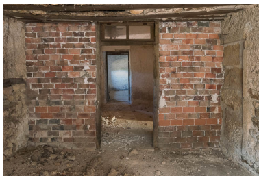
Vue intérieure de l'appentis abritant la bassie (ou arrière-cuisine). Une cloison en briques, ajoutée au XIXe siècle, a amené le bouchage d'une ancienne porte. Phot. Pierre-Marie Barbe-Richaud IVR26_20197100354NUC4A
