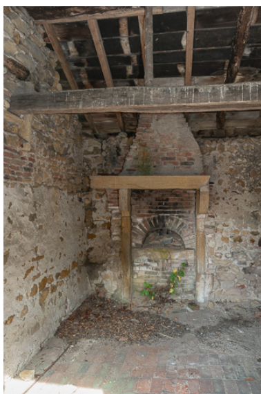
Vue intérieure du four à pain Phot. Pierre-Marie Barbe-Richaud IVR26_20197100345NUC4A
