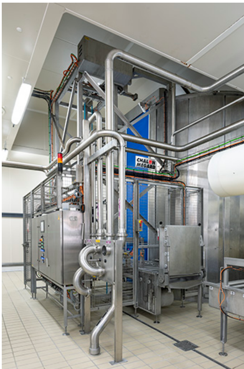
Tour de pressage : vue arrière.
