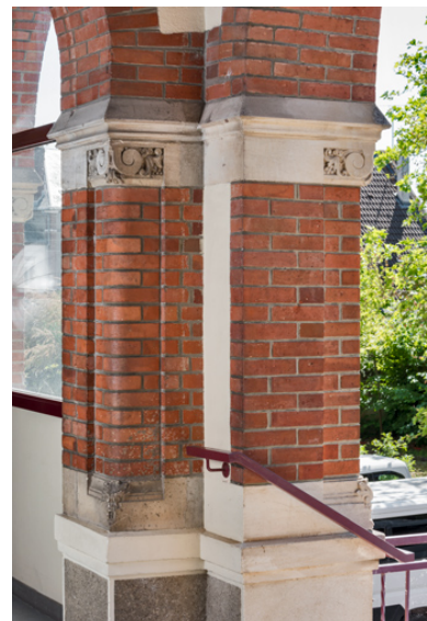
Détail de la colonne de la galerie ouverte (vue depuis la galerie). Phot. Pierre-Marie Barbe-Richaud IVR26_20238900540NUC4A
