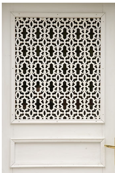
Bâtiment 62-64 rue des Forges : ferronnerie d'une porte (62 rue des Forges). Phot. Jérôme Mongreville IVR43_20082500920NUC2A
