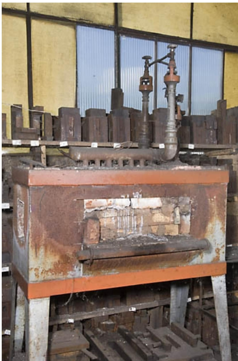
Atelier est. Four à gaz Thermidor.
