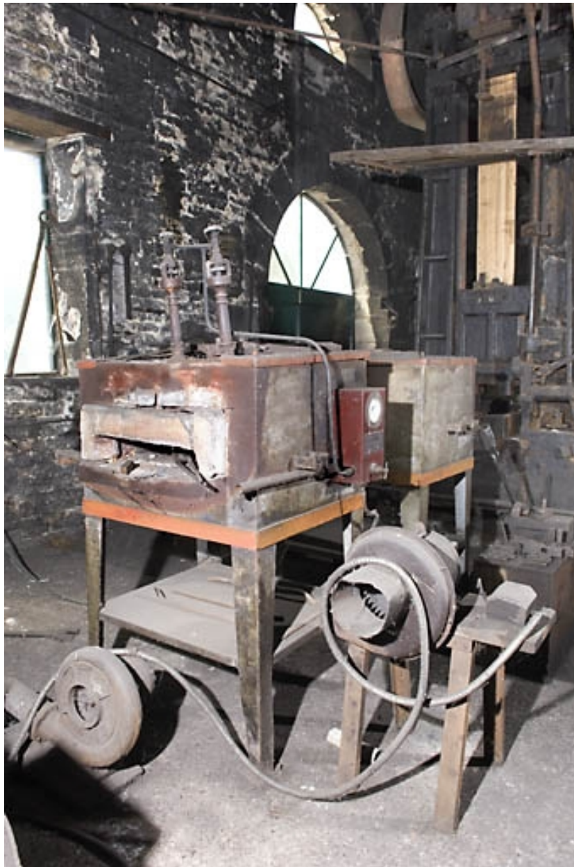
Atelier est. Fours à gaz Thermidor.
