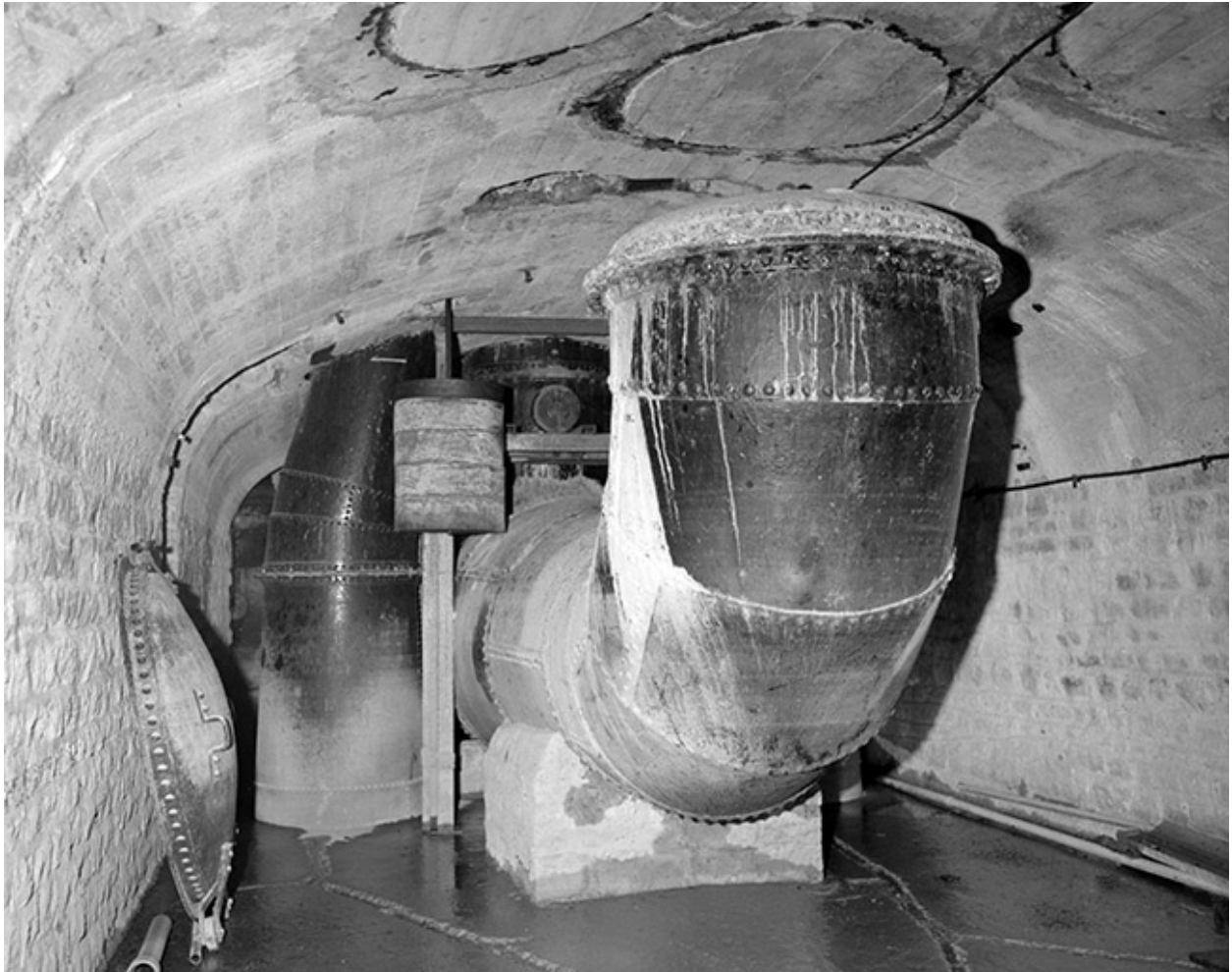
Intérieur de la centrale : collecteur en soubassement. Au premier plan, coude desservant autrefois le groupe de 1912.
