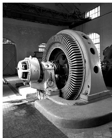
Intérieur de la centrale : alternateur de L'Eclairage Electrique. Phot. Jérôme Mongreville IVR43_19913900621X
