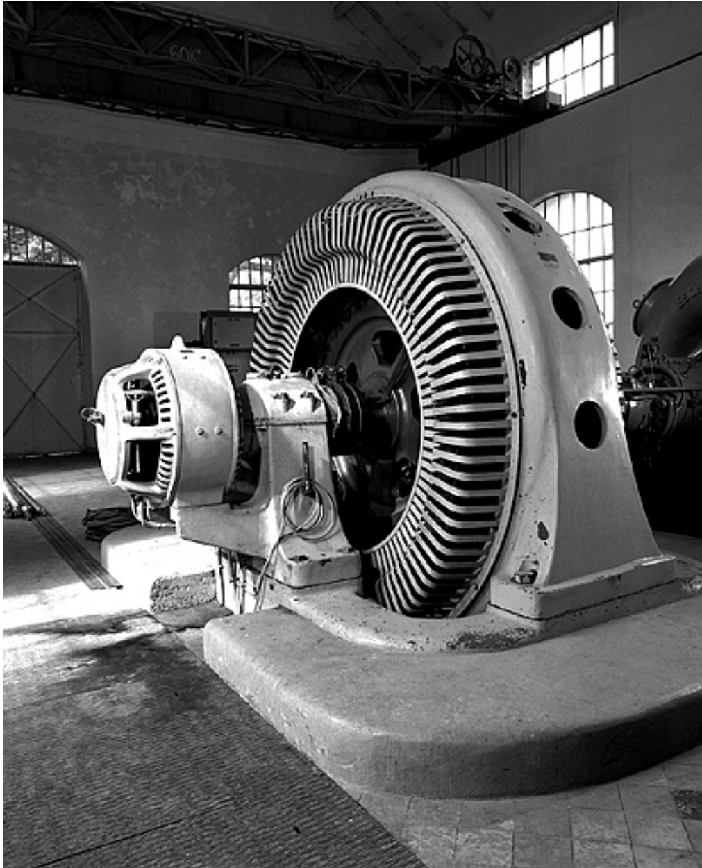
Intérieur de la centrale : alternateur de L'Eclairage Electrique.
