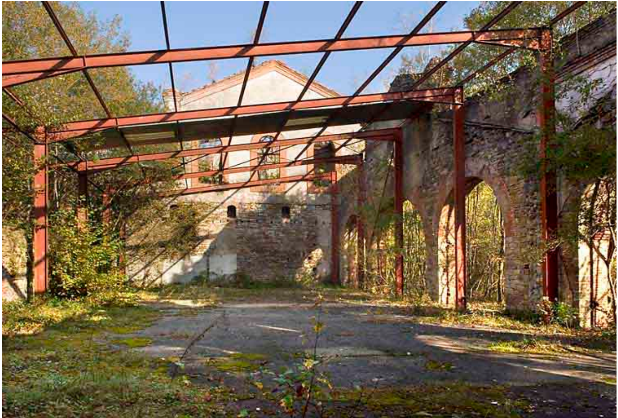
Salle des chaudières.
