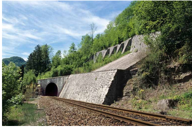
Vue d'ensemble, depuis le nord : murs de soutènement et tête côté Andelot-en-Montagne. Phot. Yves Sancey IVR43_20053900740ZA
