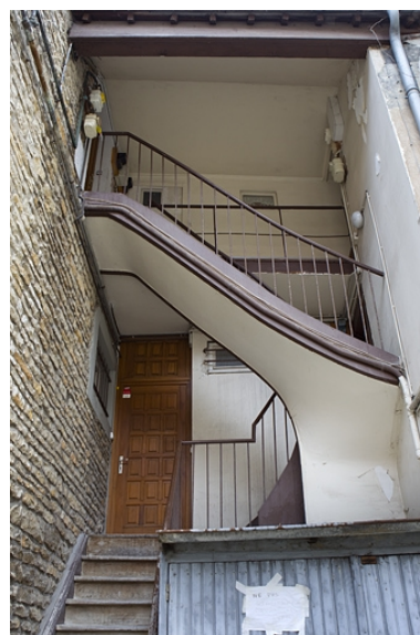
Vue d'ensemble de l'escalier à cage ouverte secondaire. Phot. Yves Sancey IVR43_20102500783NUC2A
