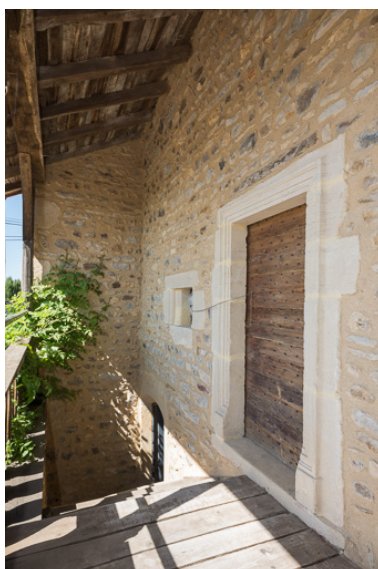
Vue de la galerie, protégée par un débord de toit soutenu par le dépassement des murs-pignons Phot. Pierre-Marie Barbe-Richaud IVR26_20197100248NUC4A
