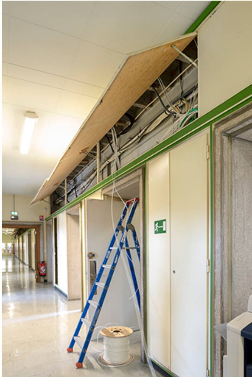
1er étage de soubassement : gaines techniques dans le couloir.
