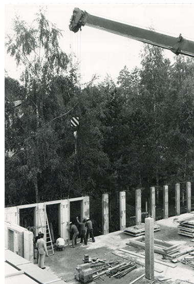
[Construction du laboratoire de métrologie, rez-de-chaussée : pose d'un élément du mur occidental], 1981. IVR43_20192500528NUC2A
