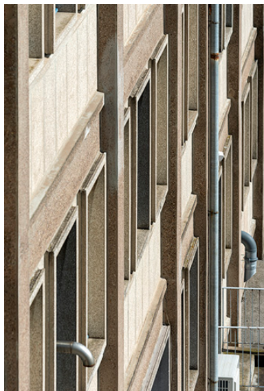
Façade postérieure, corps oriental : baies, vues en plongée et en enfilade. Phot. Sonia Dourlot IVR43_20192500217NUC4A
