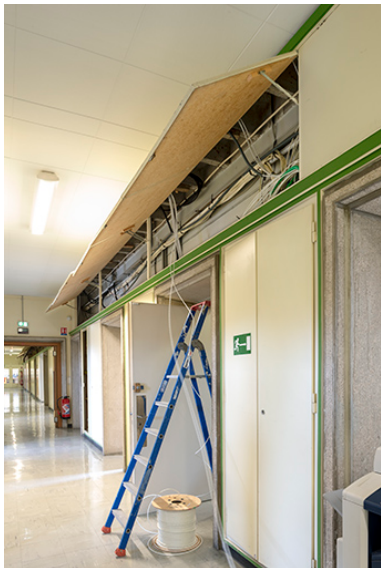
1er étage de soubassement : gaines techniques dans le couloir. Phot. Sonia Dourlot IVR43_20192500249NUC4A
