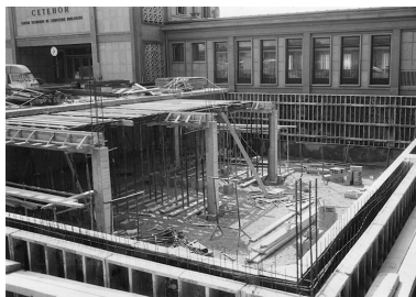
[Construction du laboratoire de métrologie, soubassement : coffrage des murs de la partie occidentale], 1981. IVR43_20192500527NUC2A
