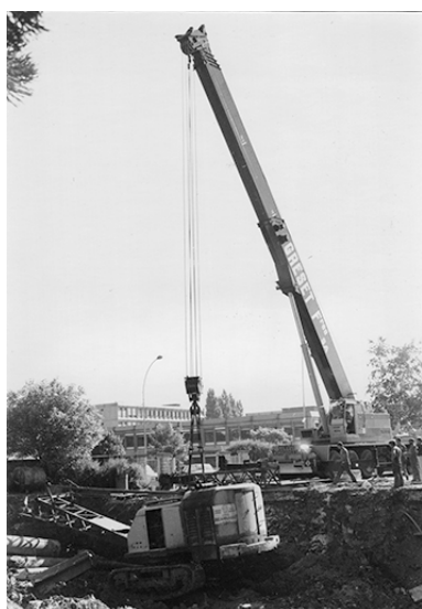
[Construction du laboratoire de métrologie, fondations : sortie à l'aide d'une grue de la sonnette utilisée pour le battage des pieux], 1981. IVR43_20192500520NUC2A
