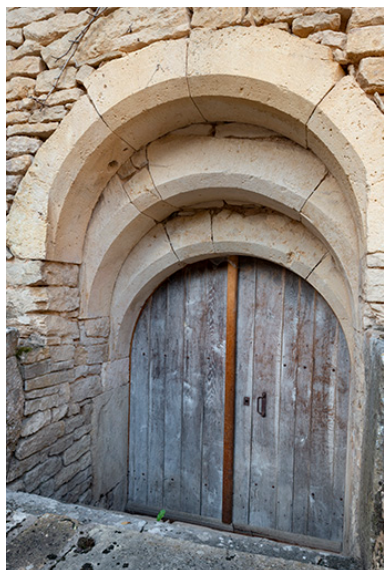
Porte de cave de l'aile ouest donnant sur la cour. Phot. Jérôme Mongreville IVR43_20187000698NUC4A
