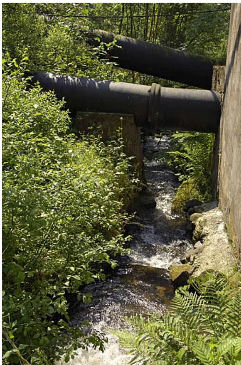
Arrivée des conduites forcées.
