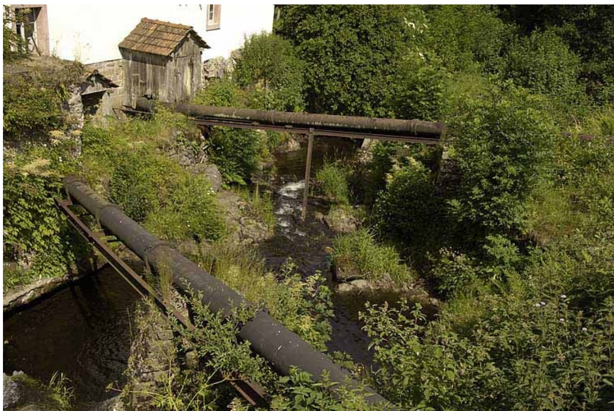
Conduites forcées alimentant les turbines hydrauliques.
