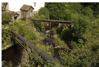
Conduites forcées alimentant les turbines hydrauliques. Phot. Jérôme Mongreville IVR43_20057000289NUCA
