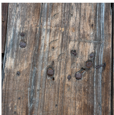
Détail du vantail de la porte de remise. Phot. Pierre-Marie Barbe-Richaud IVR26_20187100322NUC4A
