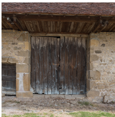
Façade antérieure du bâtiment agricole. Porte de la remise. Phot. Pierre-Marie Barbe-Richaud IVR26_20187100319NUC4A
