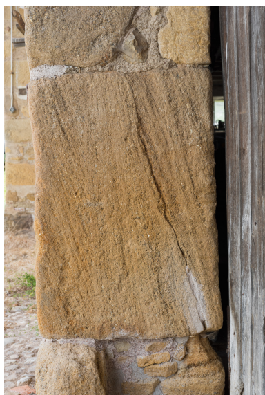
Détail du piédroit de la porte de remise. Phot. Pierre-Marie Barbe-Richaud IVR26_20187100321NUC4A
