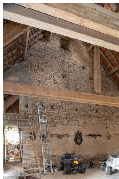
Bâtiment agricole. Mur de refend entre la remise et l'étable. Phot. Pierre-Marie Barbe-Richaud IVR26_20187100324NUC4A
