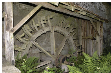
Détail de la roue hydraulique en dessous. Phot. Jérôme Mongreville IVR43_20057000279NUCA
