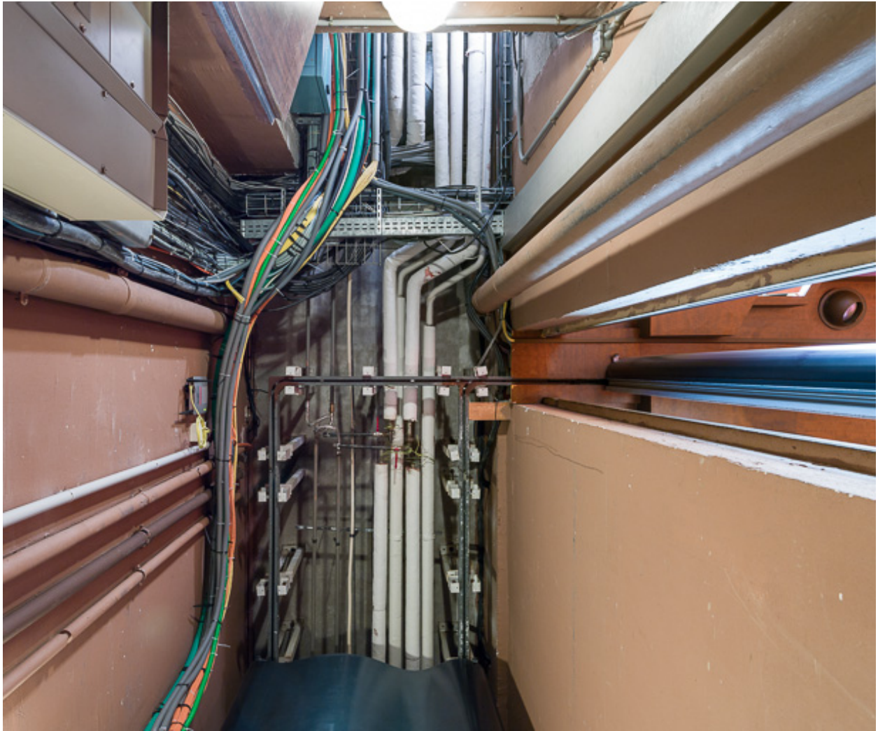
Salle des Assemblées : vue du système de rails pour faire coulisser manuellement la cloison.
