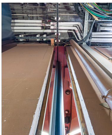
Salle des Assemblées : vue du système de rails pour faire coulisser manuellement la cloison. Phot. Pierre-Marie Barbe-Richaud IVR26_20142102183NUC2A
