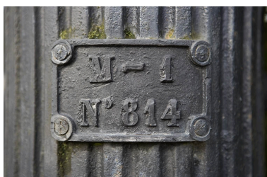
Plaque vissée sur le fût de la pompe droite. Phot. Yves Sancey IVR43_20073900035NUCA
