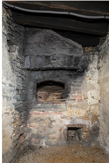
L'ensemble du four. Phot. Nicolas Waltefaugle IVR26_20258900271NUC4A
