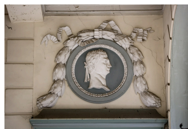
Escalier d'honneur, rez-de-chaussée : détail du dessus de porte droit. Phot. Yves Sancey IVR43_20082500551NUC2A
