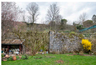
Vue depuis la terrasse en terre-plein en façade postérieure (second étage). Phot. Jérôme Mongreville IVR43_20233900150NUC4A
