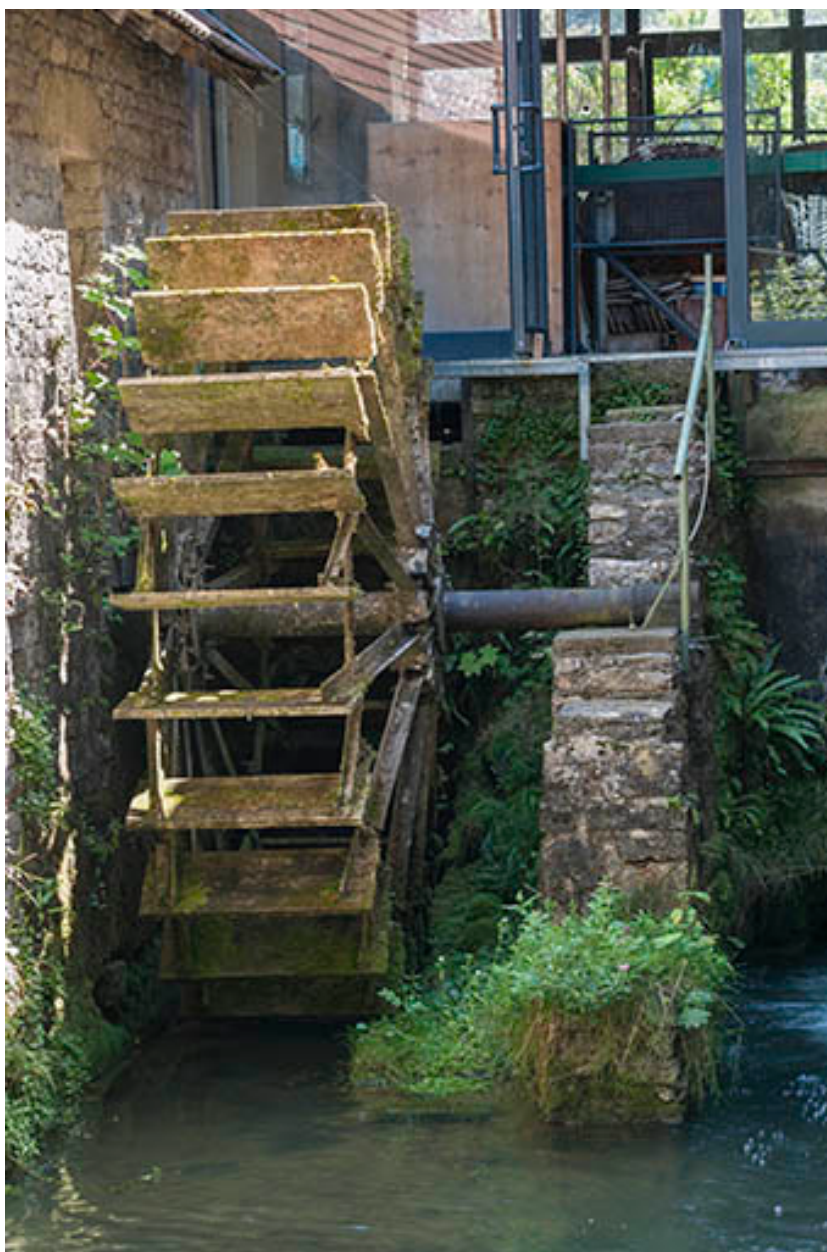
La roue hydraulique en-dessous.
