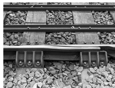
Viaduc : appareil de dilatation. Les extrémités des rails, amincies et guidées dans des coussinets, peuvent glisser l'une contre l'autre lorsque les travées métalliques se dilatent.
