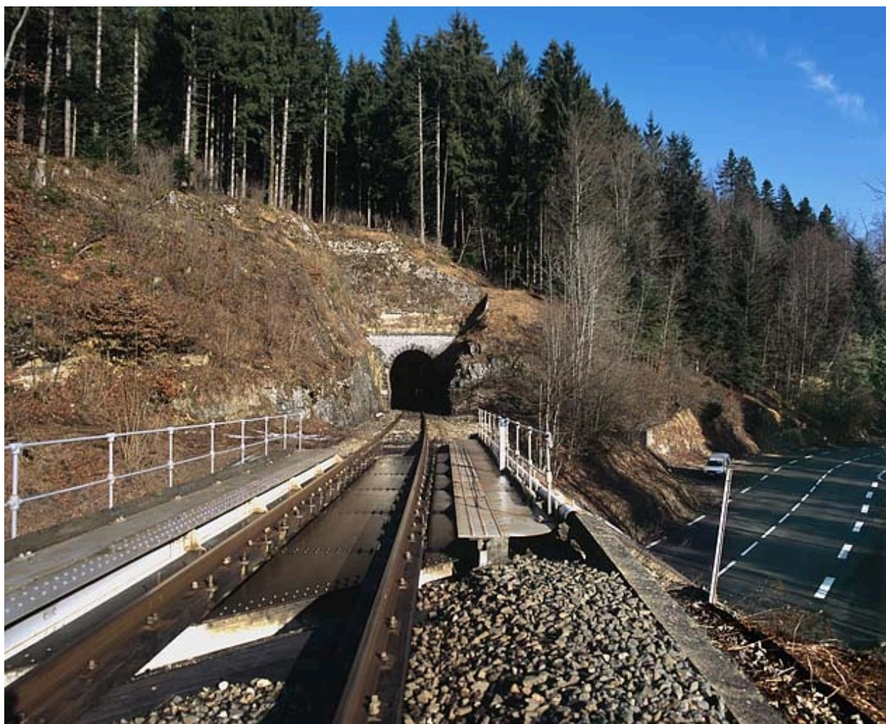
Tunnel : tête côté La Cluse, depuis la voie et le pont sur la R.N. 5.
