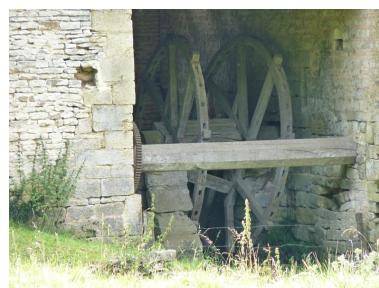
Détail de la roue du moulin, toujours en place mais effondrée. Phot. Baptiste Quost IVR26_20162100650NUC2A
