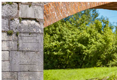
Détail de la voûte en brique et de l'échelle de crue sur la culée.
