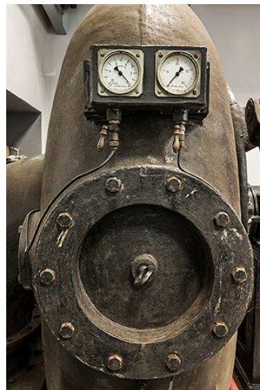
Bâche de la turbine du groupe 4. Phot. Jérôme Mongreville IVR43_20152501785NUC4A
