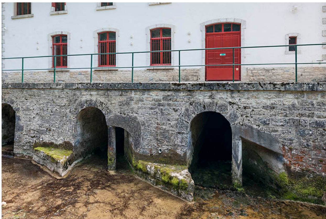
Conduits d'évacuation des groupes turbo-alternateurs.
