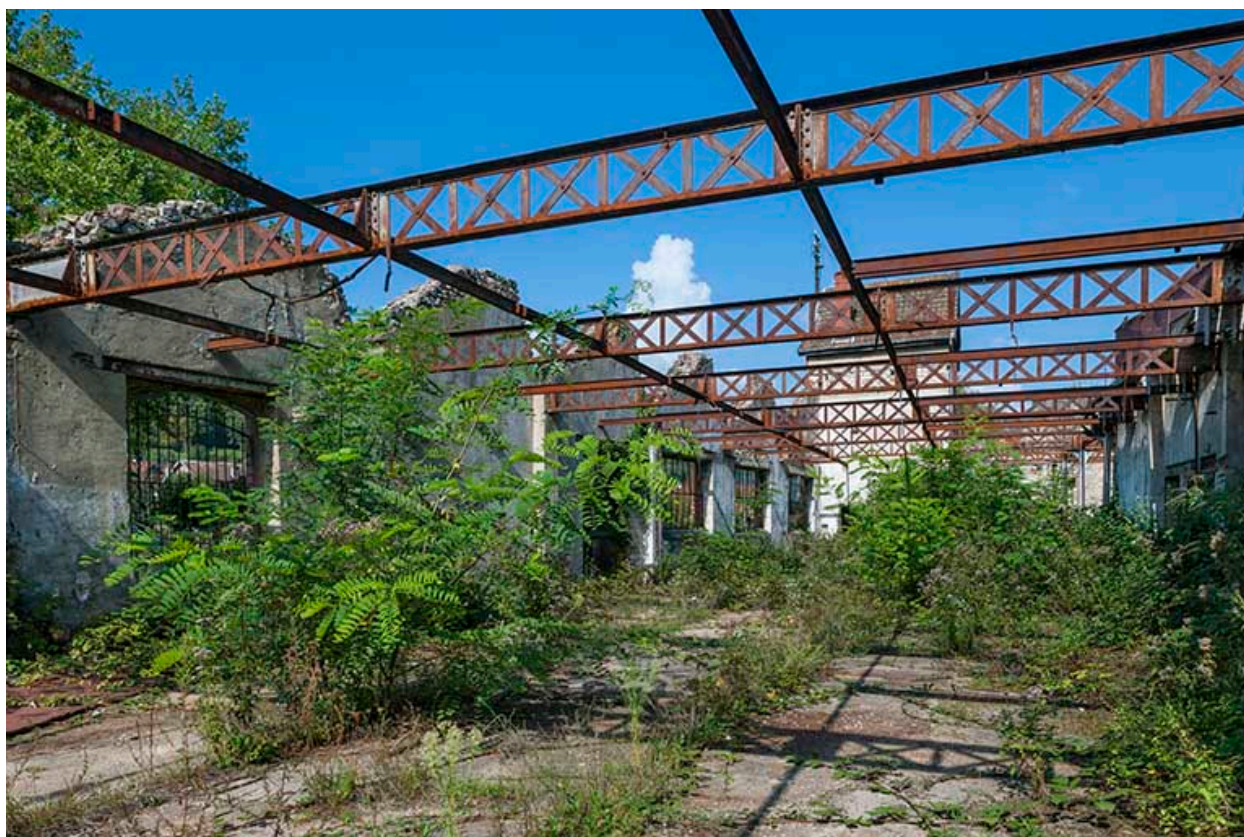
Vue Intérieure de l'atelier de fabrication.
