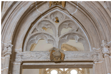
Détail : linteau et tympan ajouré, vus de face. Phot. Pierre-Marie Barbe-Richaud IVR26_20237100310NUC4A
