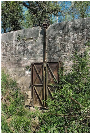
Vanne de l'aqueduc.
