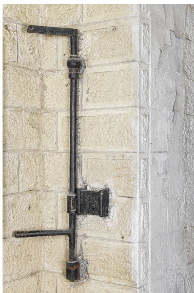
Taquet pivotant bloquant ou activant la bascule du pont. Phot. Thierry Kuntz IVR26_20252100229NUC4A
